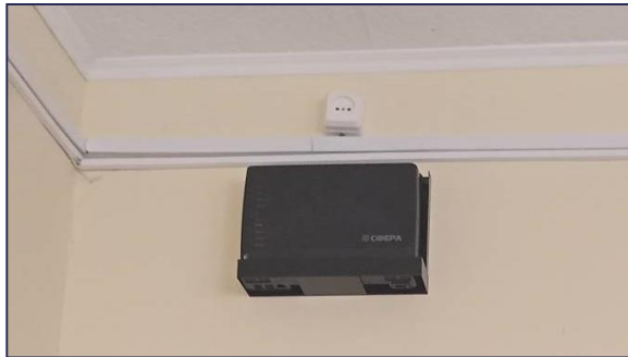
Устройства для подавления сигнала мобильной связи (установлены в аудиториях рядом с туалетными комнатами)
